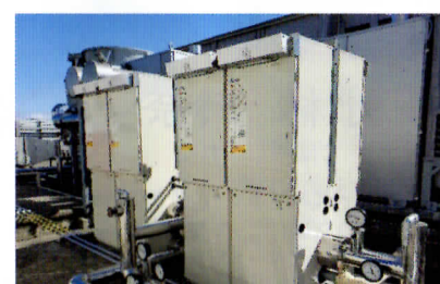
【新 冷温水発生機(空調設備)】
